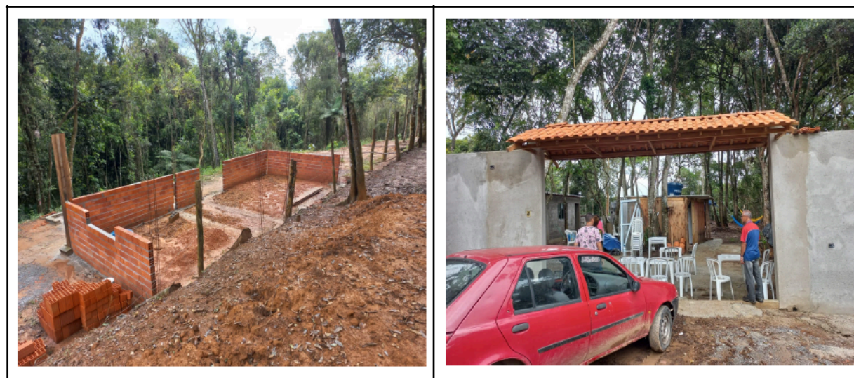
Figuras 06 e 07: Registro fotográfico de infrações - Mauá
