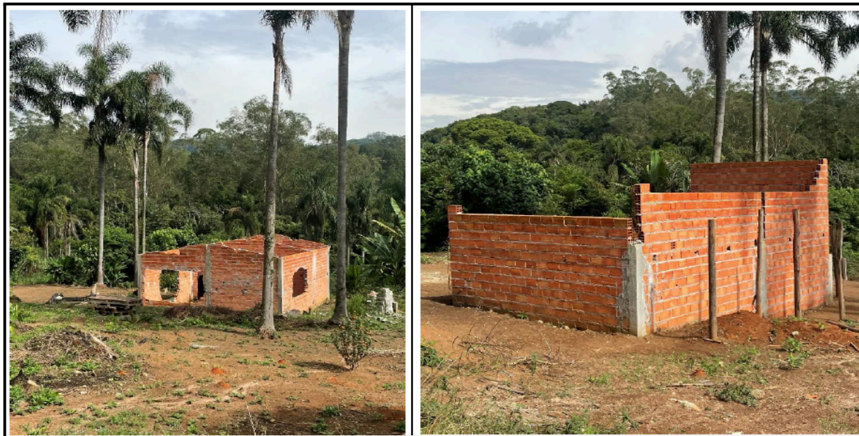
Figuras 13 e 14: Registro fotográfico de infrações – Ribeirão Pires
