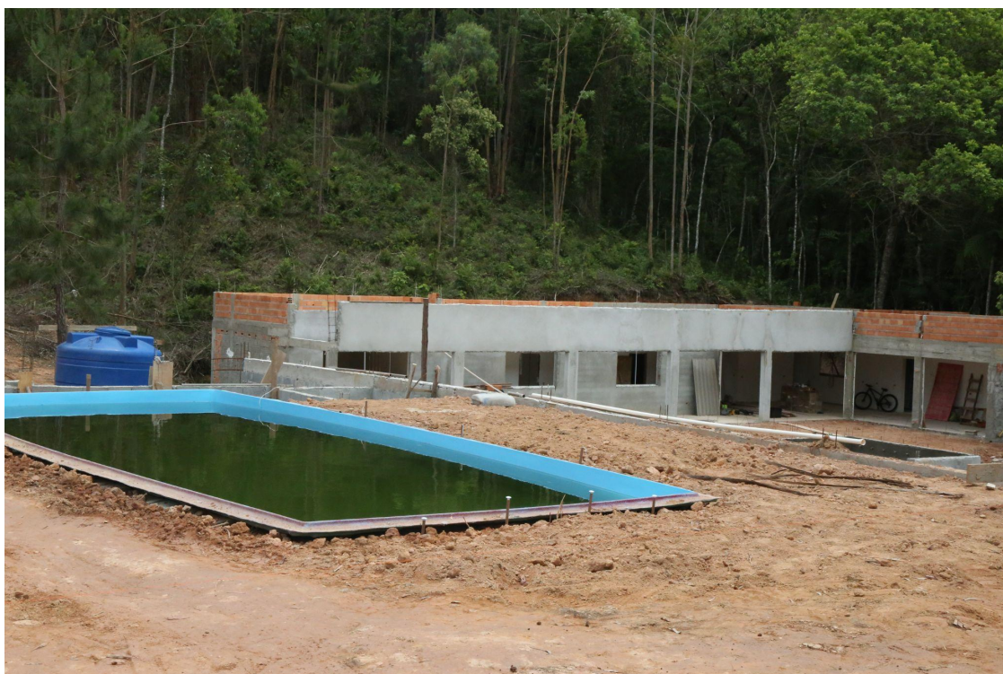
Figura 11 - Local da ação do dia 17/11/2025 no Município de Mairiporã - área 02
