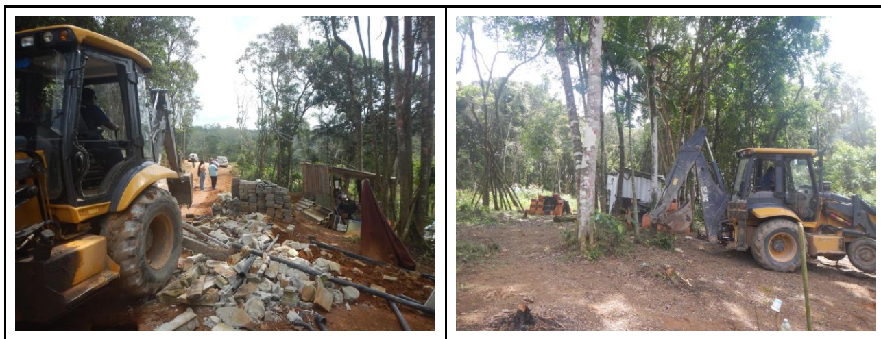
Figuras 04 e 05 - Registro fotográfico de infrações - Embu Guaçu
