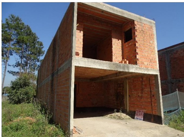
Figura 13: Construção padronizada inacabada.
