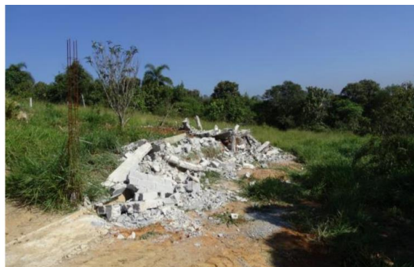
Figura 64: Construção irregular desfeita na ação.
