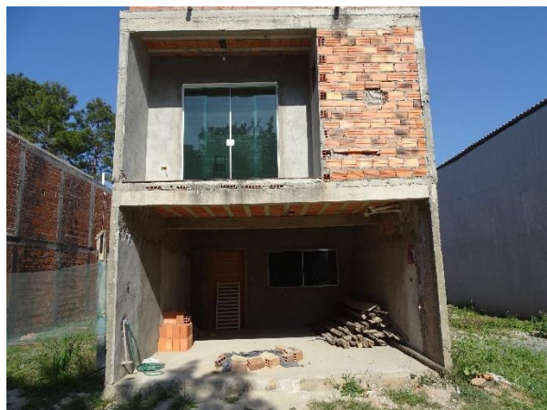
Figura 14: Construção padronizada inacabada.
