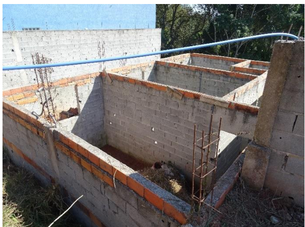
Figura 54: Construção irregular em andamento.
