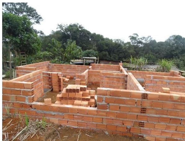
Figura 79: Construção irregular em alvenaria.
