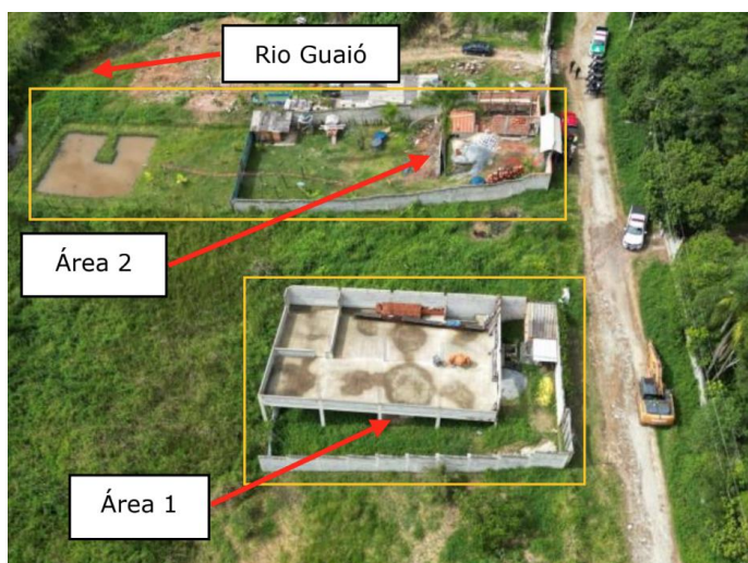
Figura 44: Duas obras em andamento no interior do imóvel vistoriado (Área 1 e Área 2).
