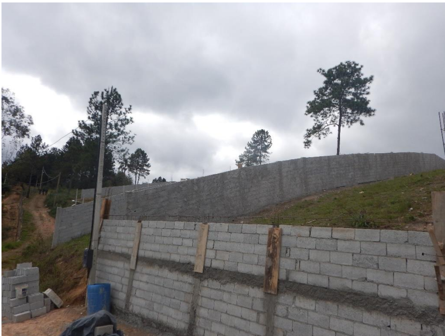
Foto 9: Muros edificados dentro de UC de proteção integral.
