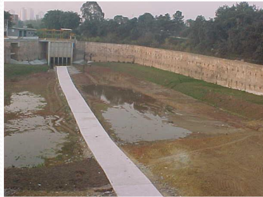
Reservatório TM2 - TM3
