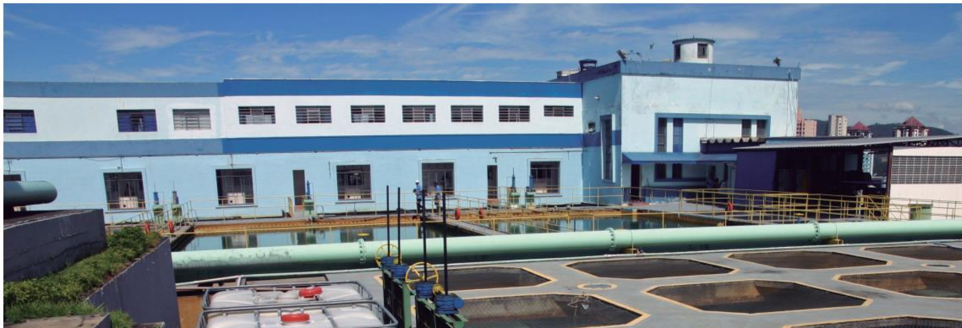
Principal Estação de Tratamento de Água de Mogi das Cruzes – ETA Centro, trata em média 642 l/s (2020).
