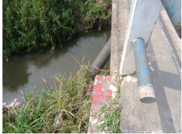
RN em estrutura de concreto da base da ponte
