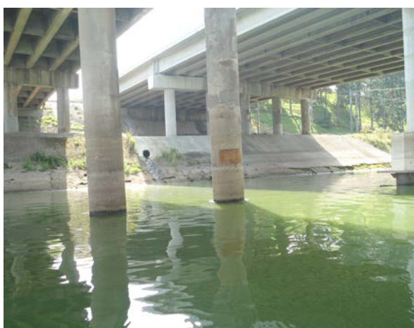
Ponto B09 sob a Rodovia dos Imigrantes. Constante floração de alga nas últimas campanhas em grande parte do reservatório
